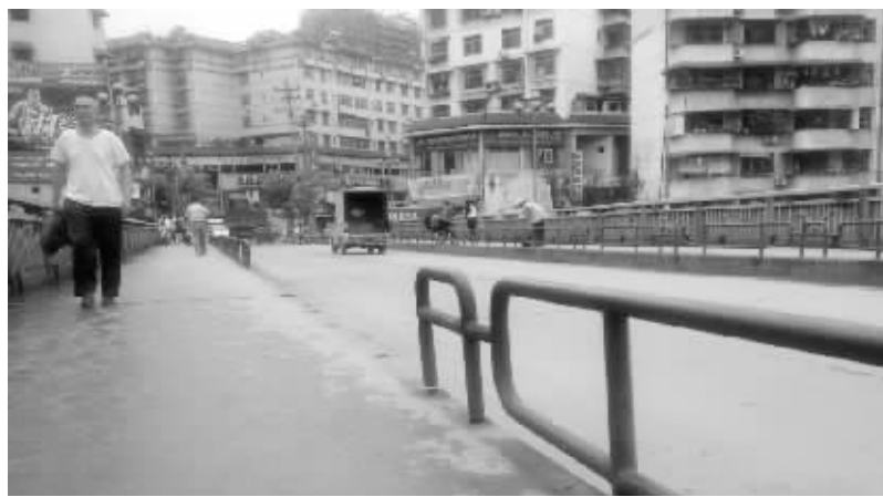
大桥护栏损坏，过往市民只好在并不宽敞的道路上小心行走。 向培东 摄
